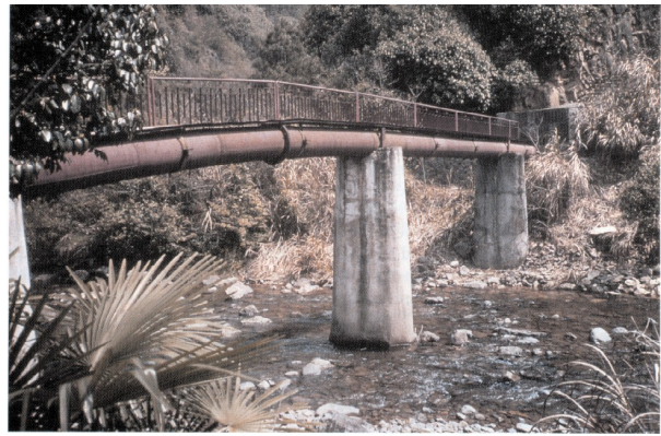
Photographie 5.31 : Canal autoporté
